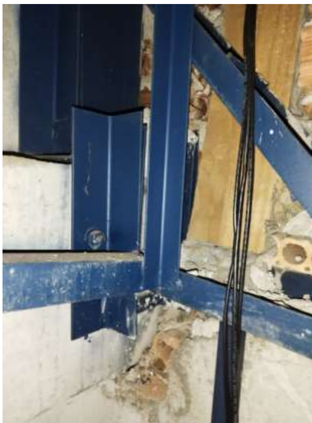
Foto 19 – Pilar sem o condutor de descida aparente
