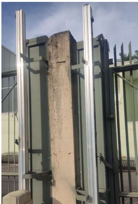
Foto 17 - Grades não conectadas ao aterramento:
