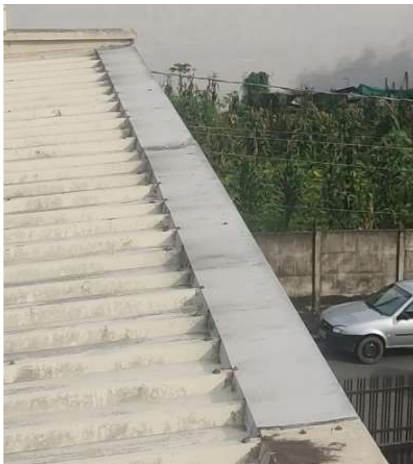
Foto 16 - Pingadeiras da platibanda sem conexão elétrica com telha
