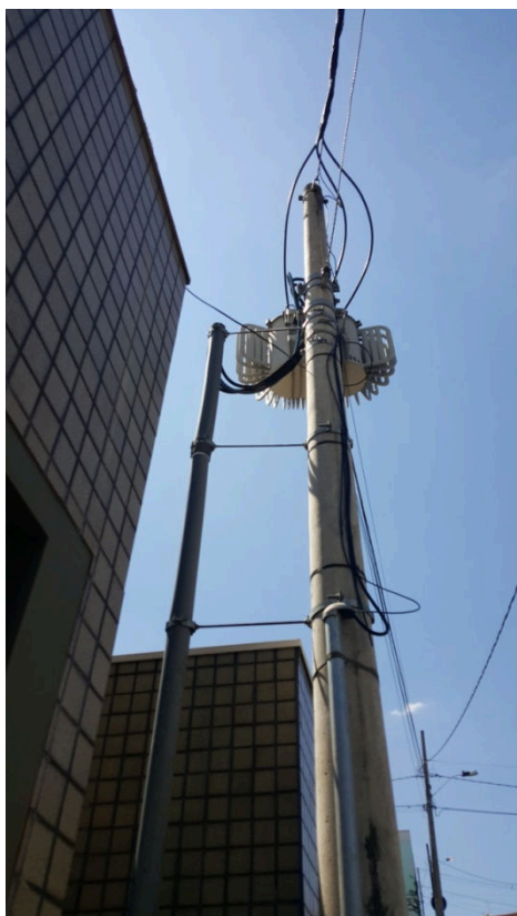
Foto 1: Subestação Nº 1 existente com Transformador de 112,5 kVA
