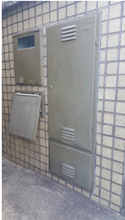
Foto 2: Quadro de medição existente - Caixa CM-18 com disjuntor tripolar de 300 A
