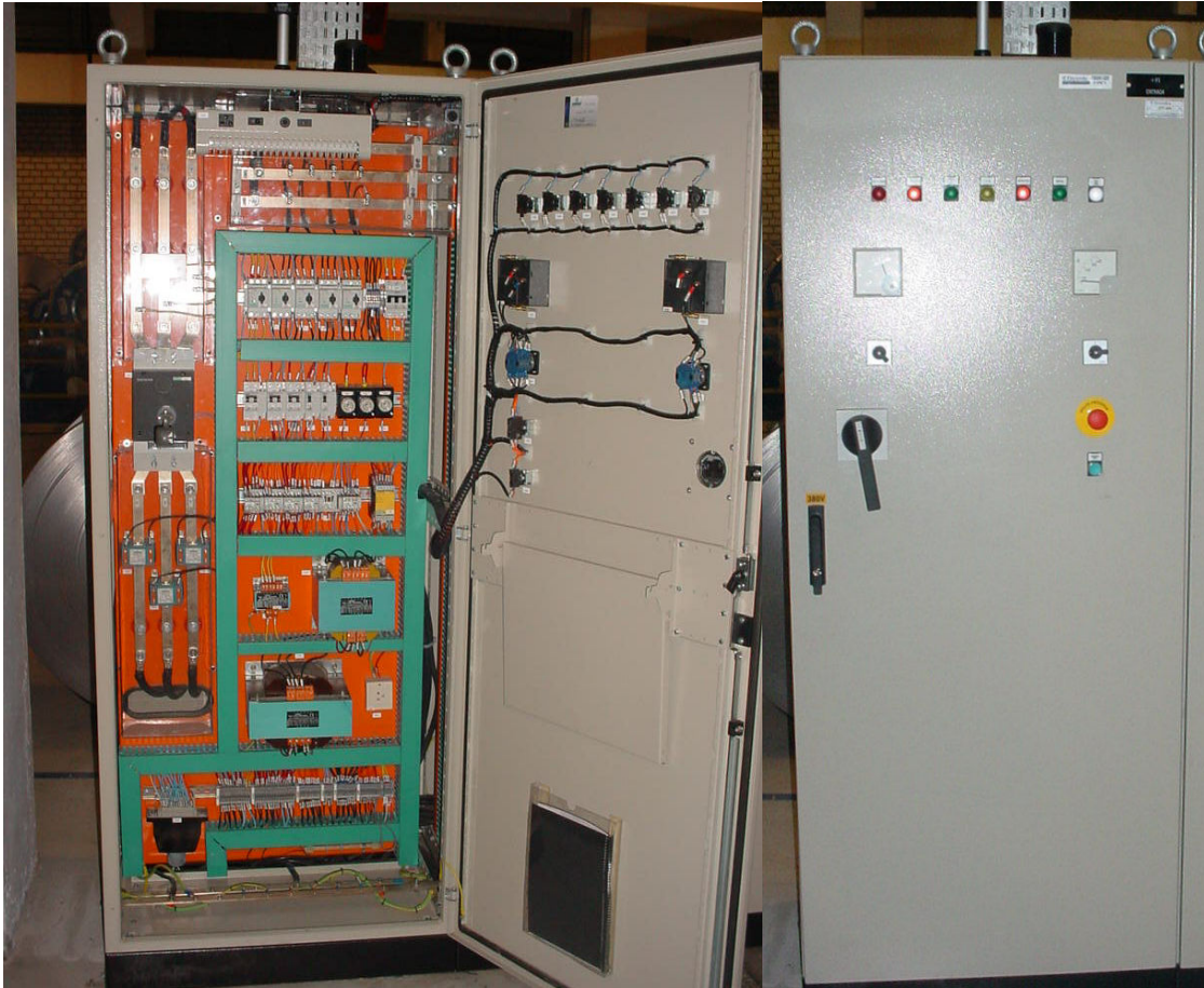
Foto 1: Aspectos do painel elétrico
